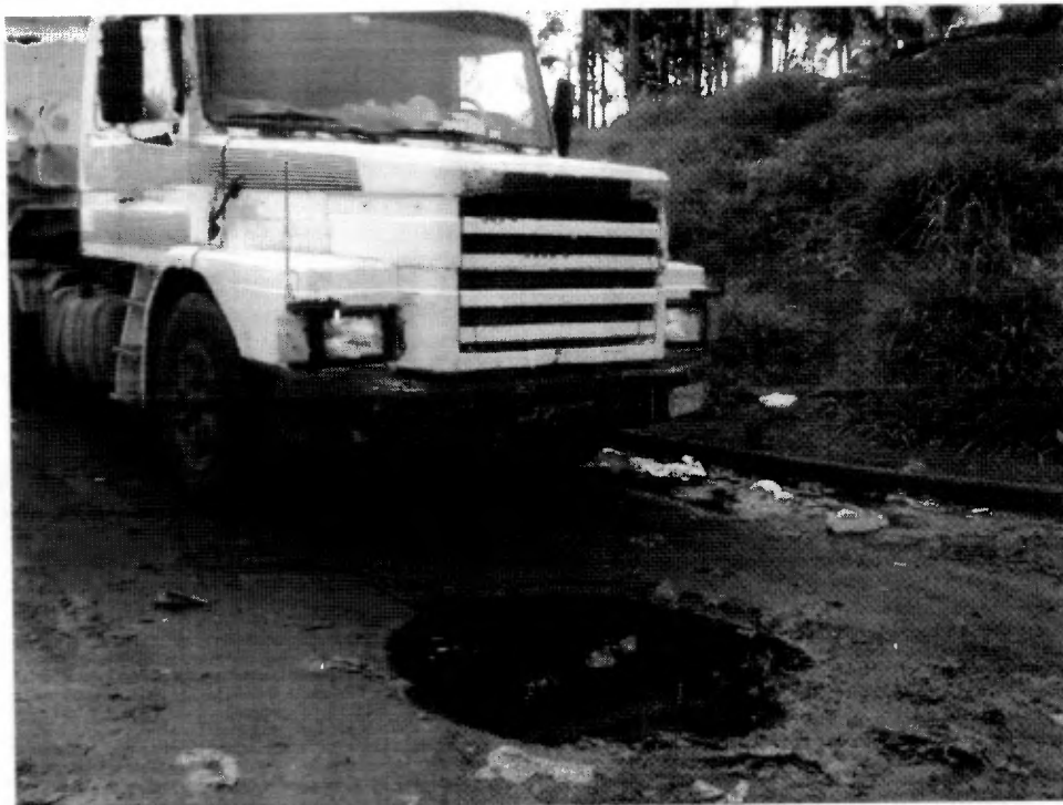
Figura 4 - Buracos na estrutura asfáltica
