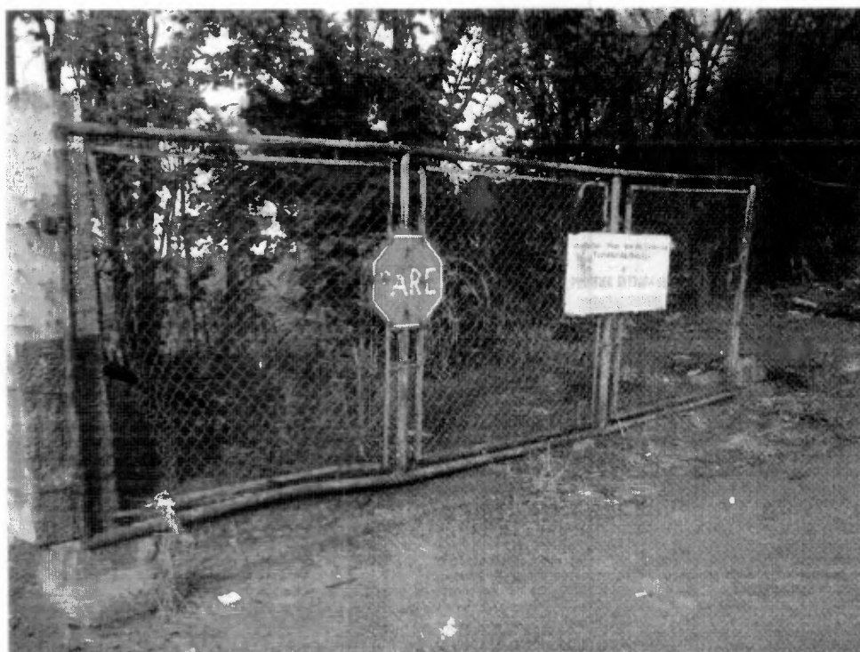
Figura 14 - Estrutura danificada do portão de entrada
