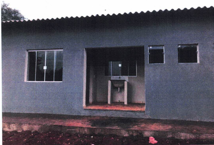
Figura 1 – Imóvel já reformado localizado na área onde se pretende implantar a Central de Triagem de Resíduos Domiciliares.
