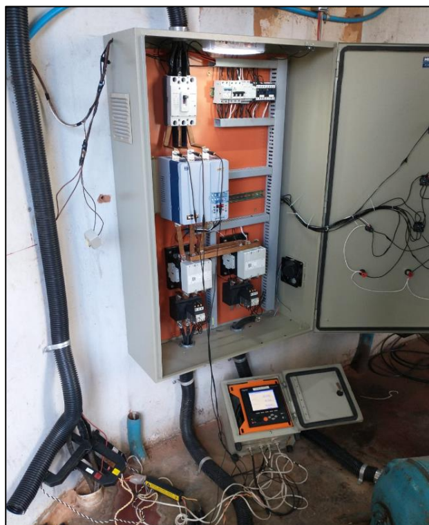
Figura 23 - Medição Motor 40CV
