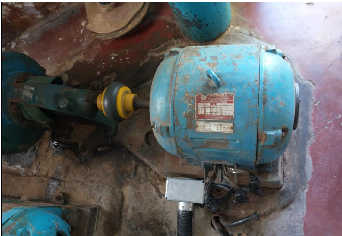
Figura 13 – Sistemas Motrizes - Sistema 2 – Motor 40CV - Bomba Rodovia
